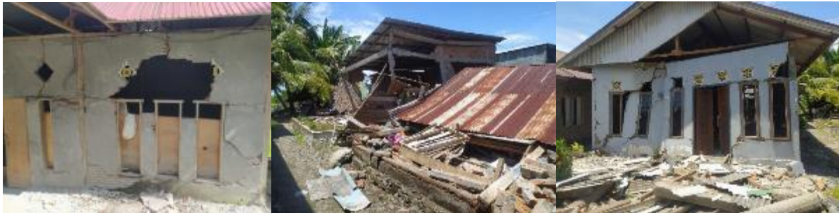
Gambar 4 Kerusakan berat beberapa rumah di Desa Mekatta, Kab. Malunda akibat gempa berkekuatan 6,2 SR pada tanggal 15 Januari 2021
