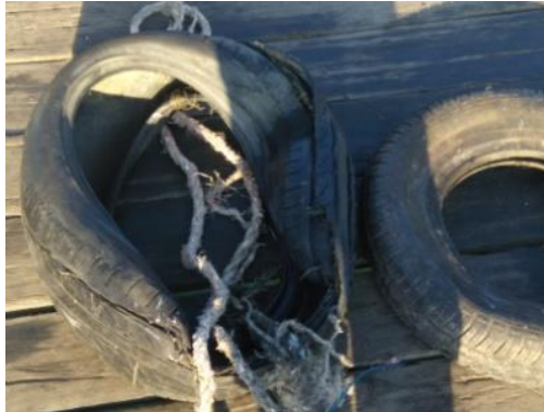
Gambar 5. Fender ban yang tidak layak digunakan di dermaga
