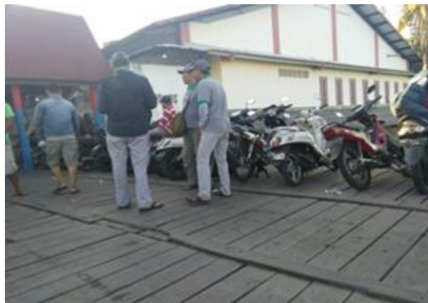
Gambar 8. Penyalahgunaan lantai trestle sebagai lahan parkir
