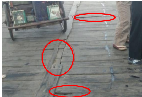
Gambar 2. Kondisi papan geladak trestle pada Dermaga Kayu Bangkoa
