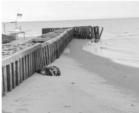
Gambar 8. Salah satu Groin yang mengalami Kerusakan di Desa Kaluku Bodo Kecamatan Galesong Selatan, Kabupaten Takalar
