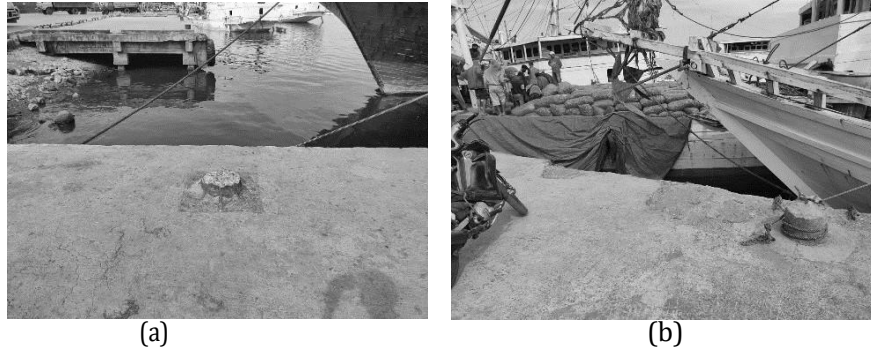
Gambar 8. Kondisi Bollard pada Dermaga Kapal Barang Pelabuhan Paotere Makassar (Survey)
