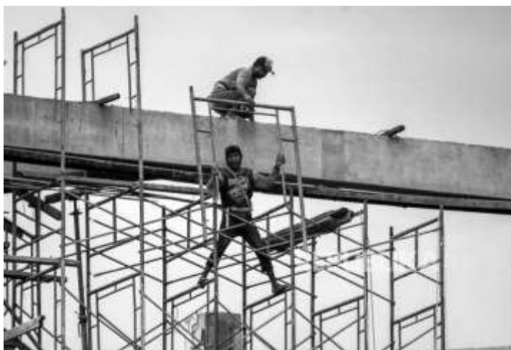
Gambar 1. Pekerja tidak memakai APD
