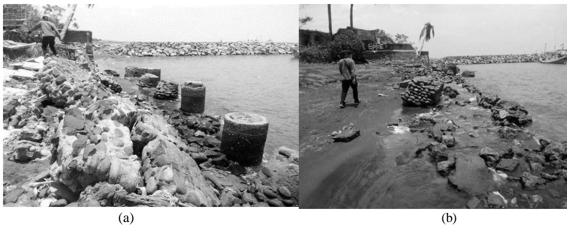
Gambar 5. Akibat rusaknya bangunan pelindung pantai, pantai mengalami kerusakan [7]
