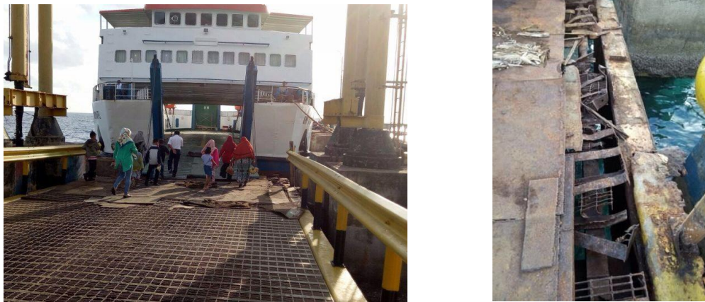
Gambar 3. (a) Kondisi jembatan Pelabuhan Penyeberangan Ferry Pamatata Kepulauan Selayar, dan (b) Kondisi jembatan penyebrangan ke kapal Ferry di Pelabuhan Pamatata, Kepulauan Selayar
