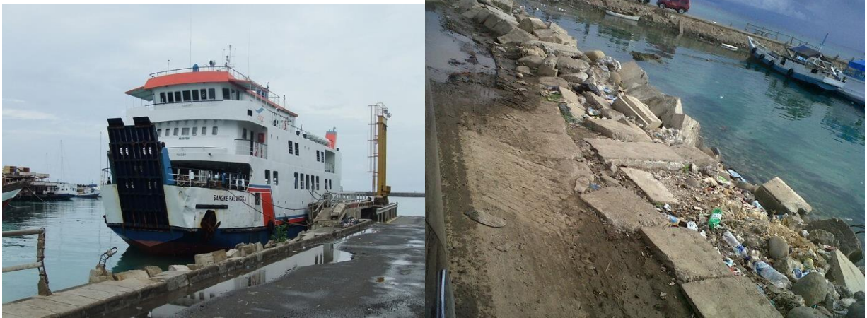
Gambar 4. Kondisi pembatas jalan di Pelabuhan Penyeberangan Ferry Bira Bulukumba
