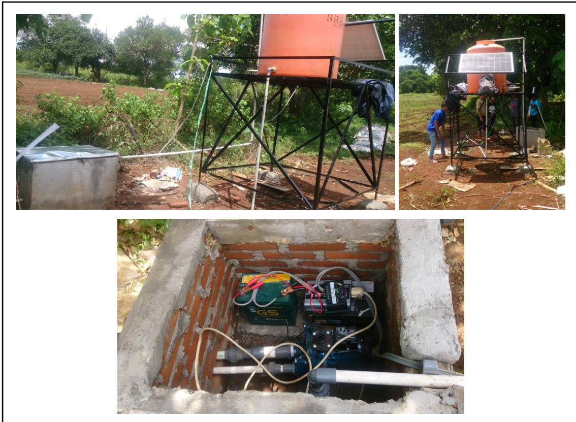
Gambar 1. Instalasi pompa dan pembangkit listrik tenaga matahari
