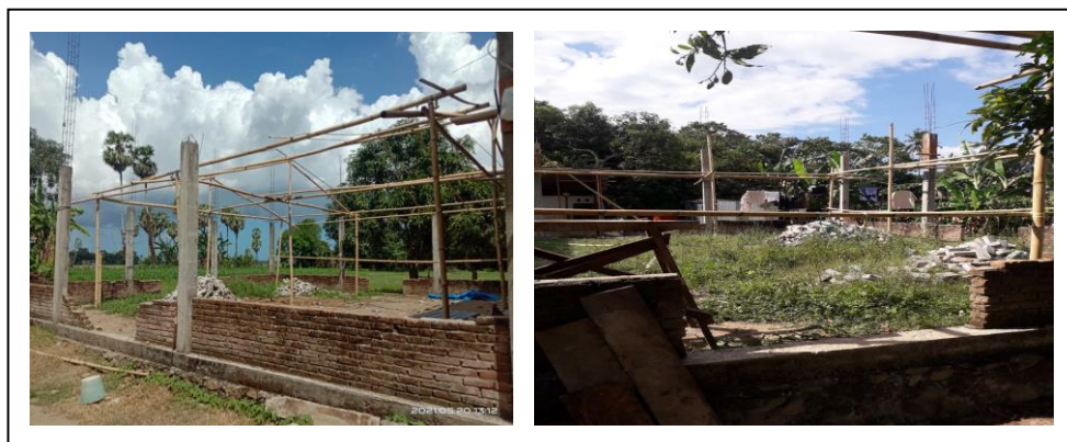
Gambar 2. Kondisi bangunan asrama santri
