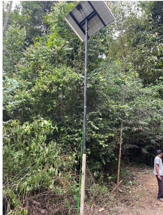
Gambar 8. Panel Surya yang dipasang
