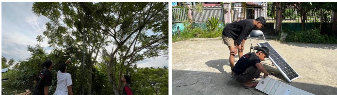
Gambar 7. Pengecekan Lampu Tenaga Surya di kawasan Pantai Kaluku
