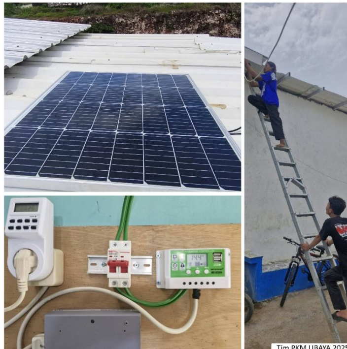
Gambar 5. Instalasi solar panel untuk menggerakkan pompa air nutrisi
