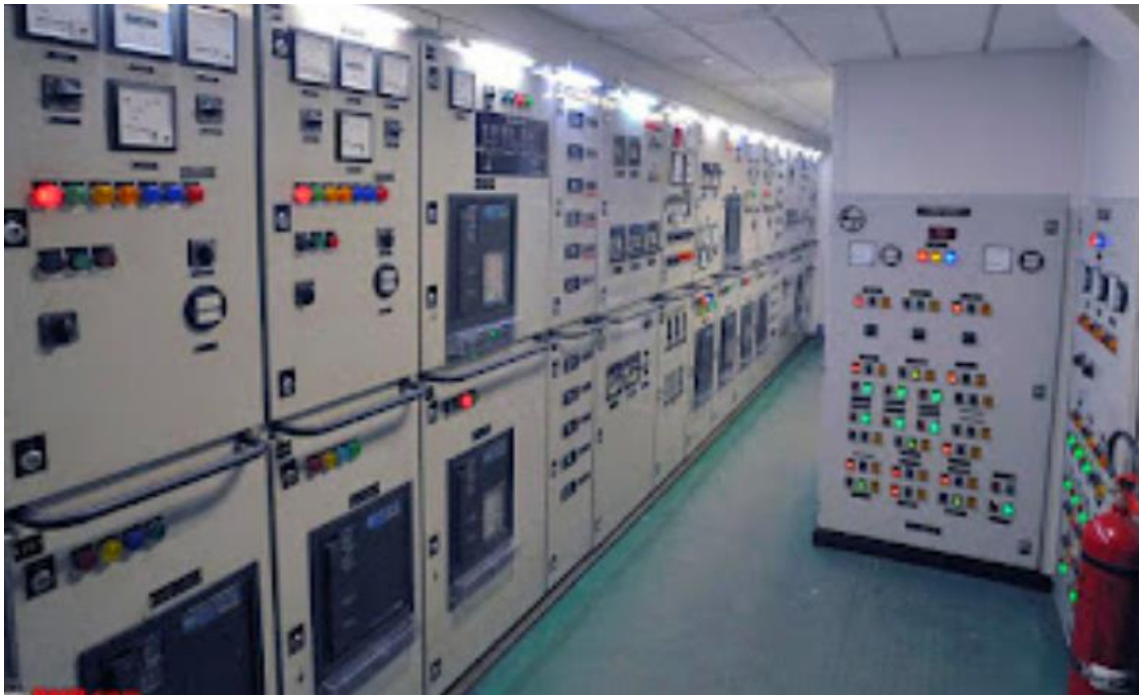
Gambar 2. Ruang kontrol listrik di kapal [7]
