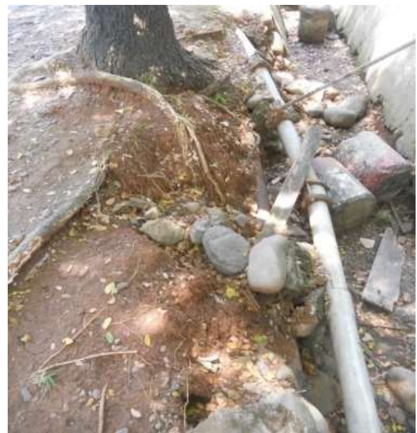
Gambar 4. Pembatas akar trembesi pada tepi Jl. Perintis Kemerdekaan
